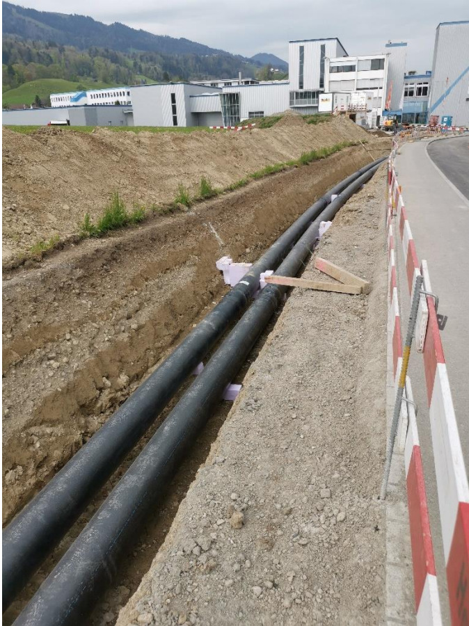
Bildlegende: Fernwärmeleitungen (Vor- und Rücklauf) entlang der Breitenstrasse in Altendorf.
