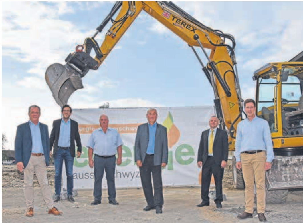
Startschuss fürs Energiezentrum Bodenwies in Galgenen, das künftig Fernwärme und Strom produzieren wird: (v. l.) die beiden Galgener Gemeinderäte Thomas Küng (Säckelmeister) und Reto Jegher (Soziales, Gesellschaft), Initiant und VR Guido Züger, Gemeindepräsident René Häberli, Mark Steiner, VRP Energie Ausserschwyz AG und EW Höfe AG, und Urs Rhyner, Geschäftsführer. Bilder Stefan Grüter
